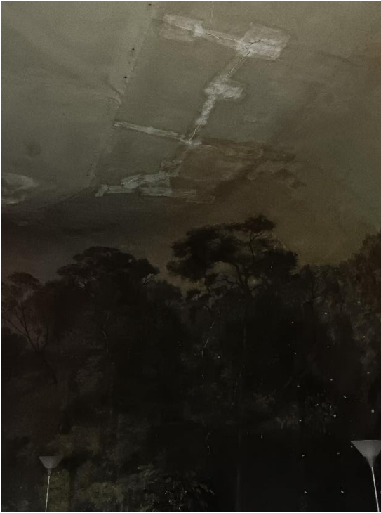
Détail des dégradations © Château de Chantilly
