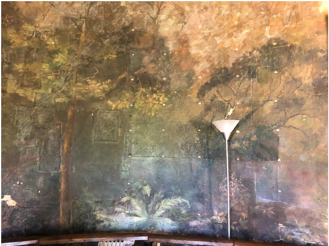
Dégradations de la fresque picturale, Salle à Manger du Hameau © Château de Chantilly
